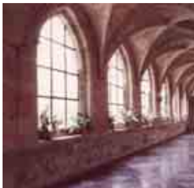
Figure 57 : Le Cloître Sud : fenêtres sans remplage
