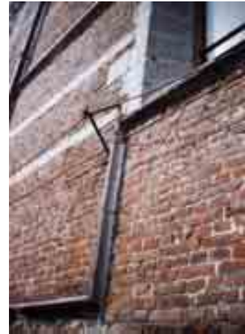
Figure 44 : Cassure dans le bandeau de pierre
